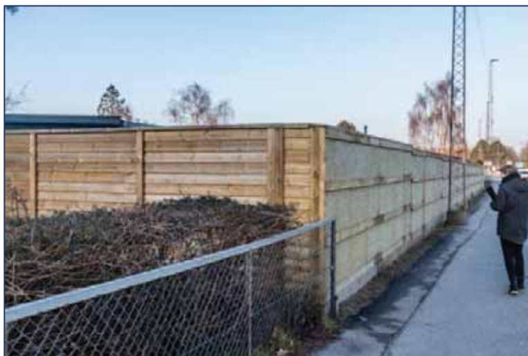
Figur 26. Her har grundejeren bygget sit eget støjhegn og brugt mineraluld på siden mod vejen. Hegnet har formentlig en god støjdæmpende virkning fordi det er tæt, har en god højde og går op i skel vinkelret på vejen. Mineralulden har ingen betydning for hegnets støjdæmpende virkning hos grundejeren.
